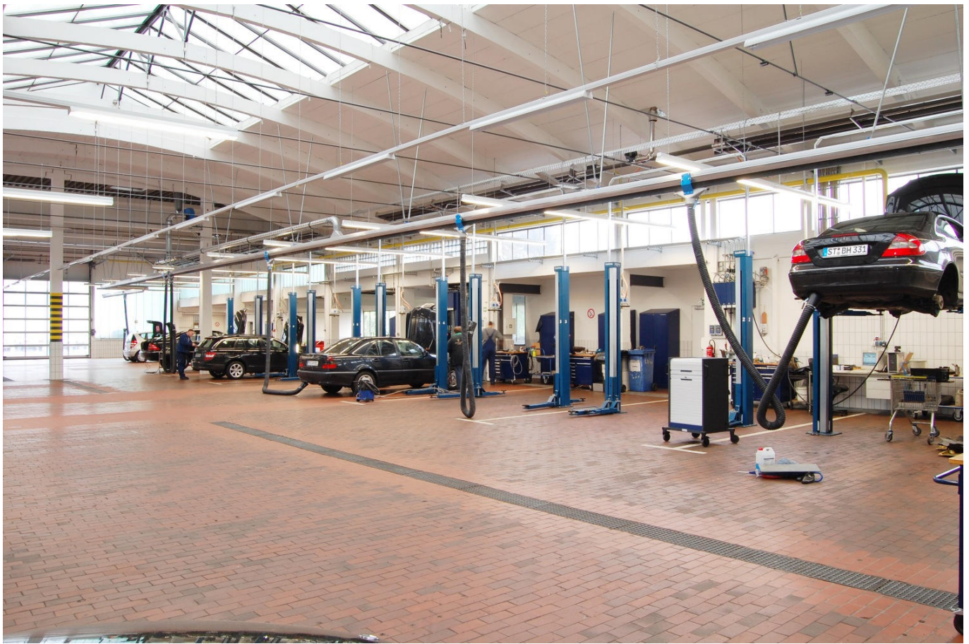
Saug Schlitzkanalanlage in einem Mercedes-Benz Betrieb
